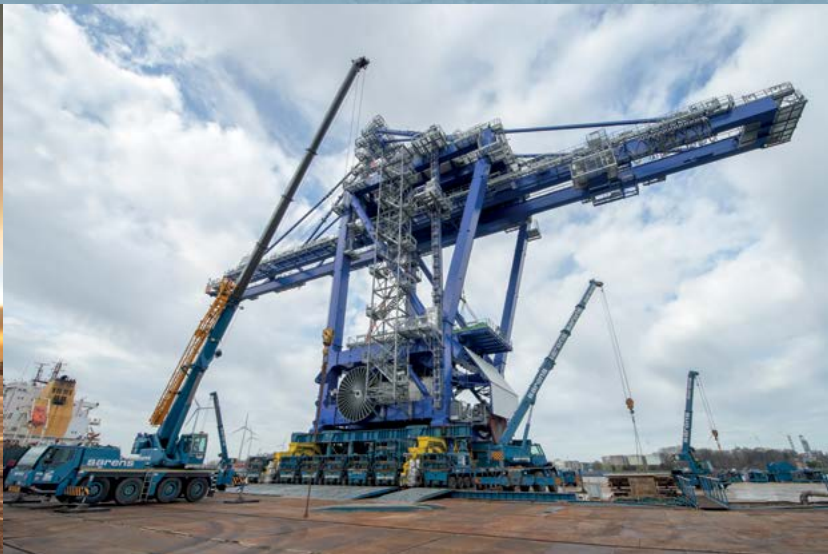
Kraan A9 wordt van het ponton afgedreden op de kade in ArcelorMittal Gent
